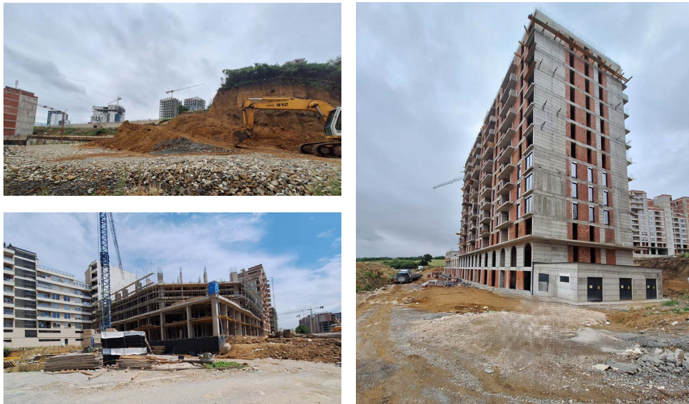
Slika 3: Postojeće stanje objekata u izgradnji (nema ograde, nema oglasne table i radovi nisu započeti).
