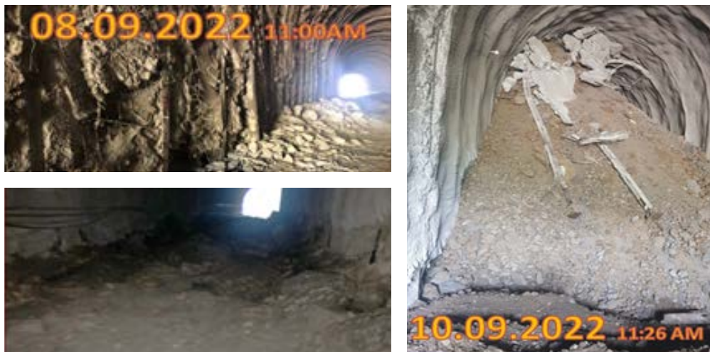
Slika5. Urušavanje Tunela 7 - fotografija od nadzornog organa
